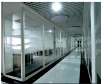
钢制防火玻璃门及隔墙
