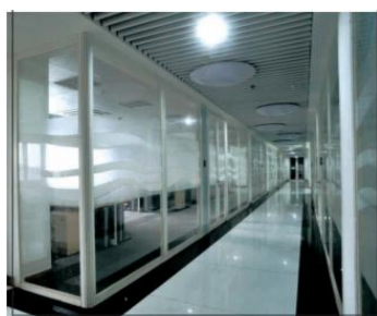
钢制防火玻璃门及隔墙
